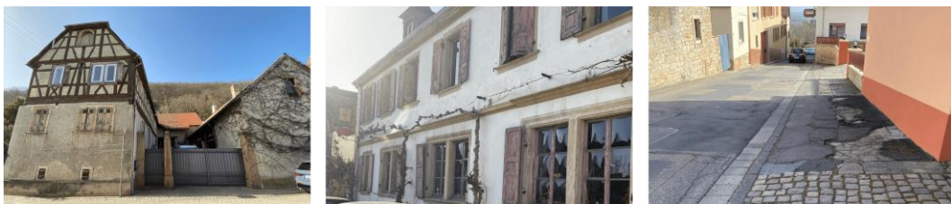
Abbildung 17: sanierungsbedürftige Fassade, Verglasung, Straßen- und Gehwegzustand
